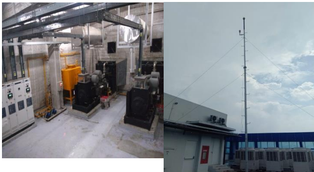
Gambar 5. Generator dan lightning rod.
